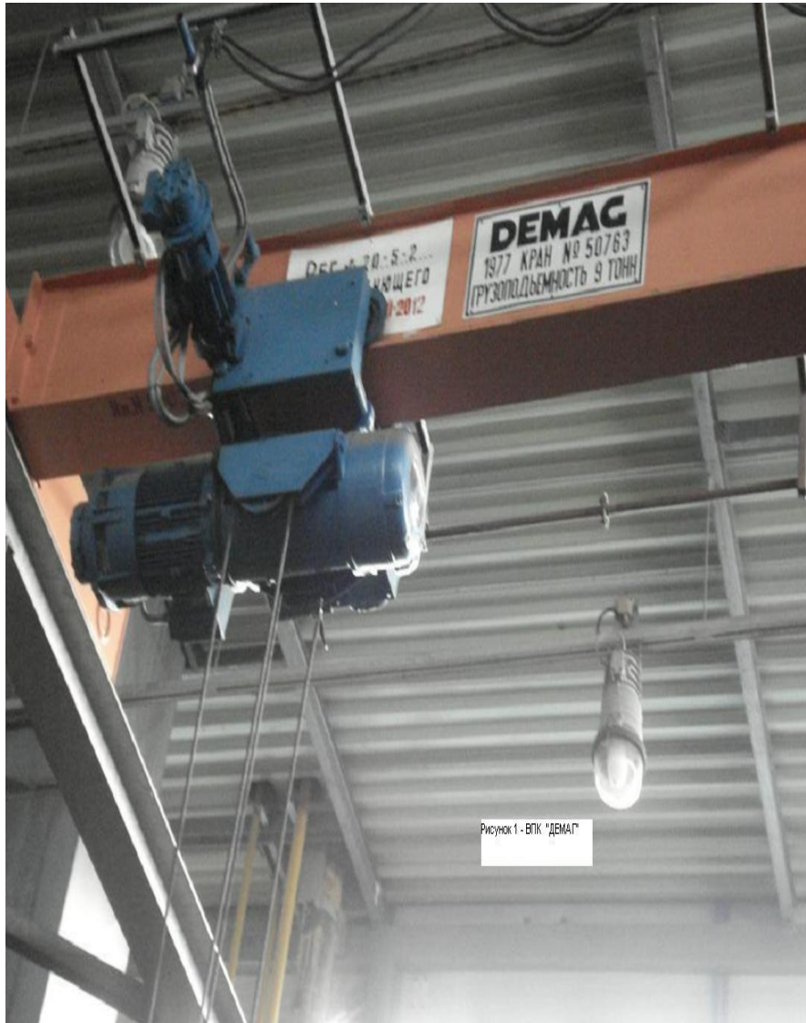
Кран-балка бокса нагнітача ГТК-101 компресерної станції магістрального газопроводу «Союз»
